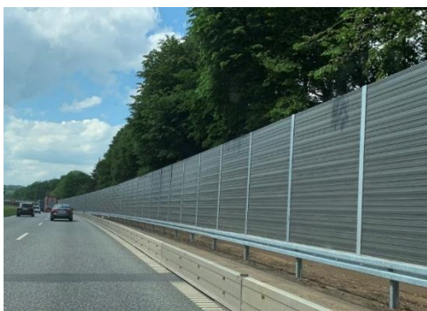
Støjskærm med kassetter i aluminium
